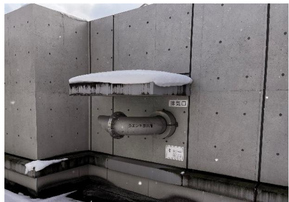
図 2 屋上のクエンチ管
