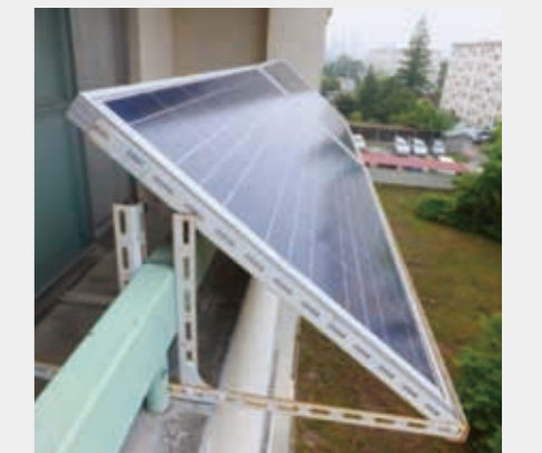
図3 宿舎のベランダに設置したソーラパネル(250W)
