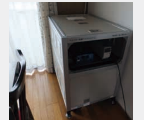
図4 宿舎のリビングに設置したハイブリッド蓄電池
