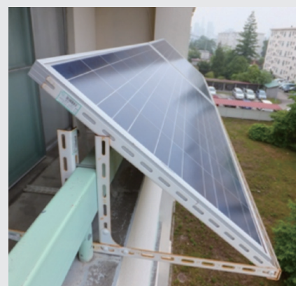
図3 宿舎のベランダに設置したソーラパネル (250W)
