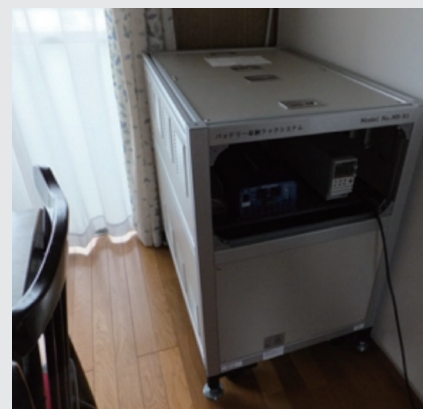
図4 宿舎のリビングに設置したハイブリッド蓄電池
